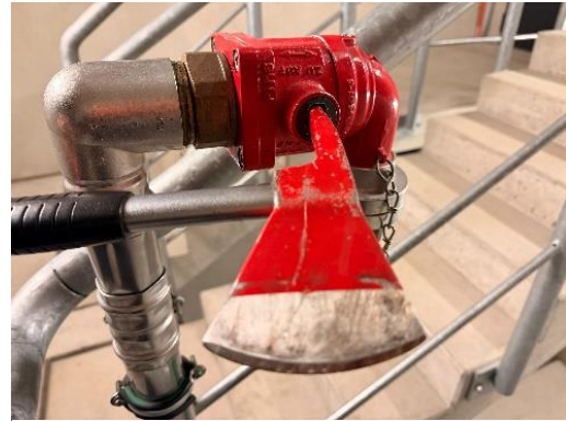
6.5.4-2 Bedienung des Absperrorganes eines Löschwasseranschlusses beispielhaft mit Feuerwehrbeil
